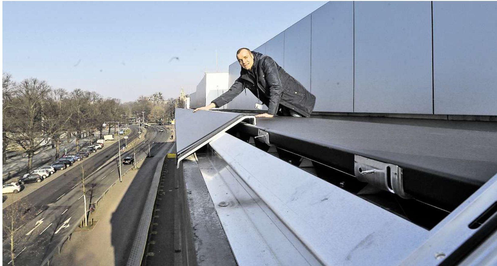
Abgedeckt: Eine Blechkonstruktion schützt jetzt die gesamte Oberfläche der Fassade. Betriebstechniker Christoph Titsch zeigt die Lösung.
